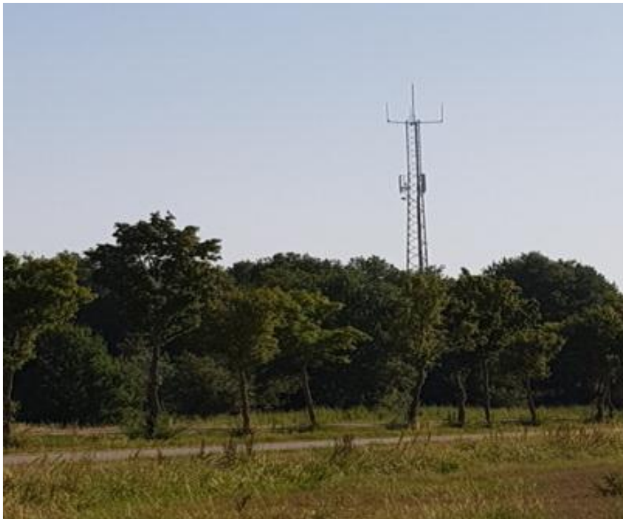
Figuur 14. Antennemast van 40 meter in Borculo. Inpassing in het landschap is een illusie
